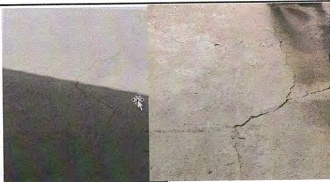
Foto 4: PISO CON GRIETAS Y EN MAL ESTADO
