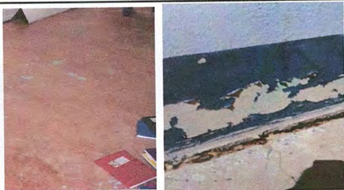
Foto 3: PISO CON GRIETAS Y EN MAL ESTADO
